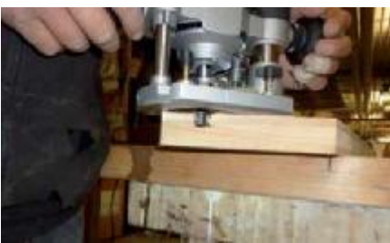
7. Mit einer Oberfräße wird der seitliche Durchbruch für den Gewindebolzen min.13mm breit und 13mm tief gefräßt.
